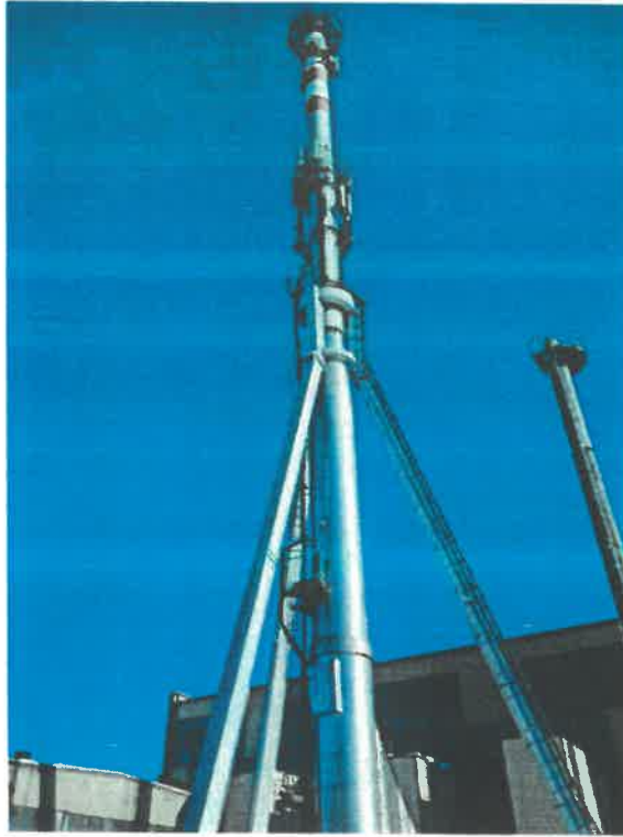
Zał. nr 1: Widok ogólny instalacji radiokomunikacyjnej.
