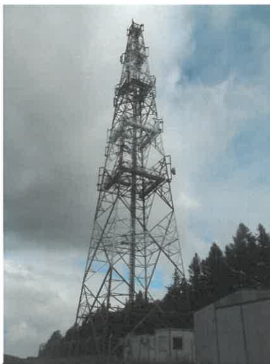
Zal. nr 1: Widok ogólny instalacji radiokomunikacyjnej.
