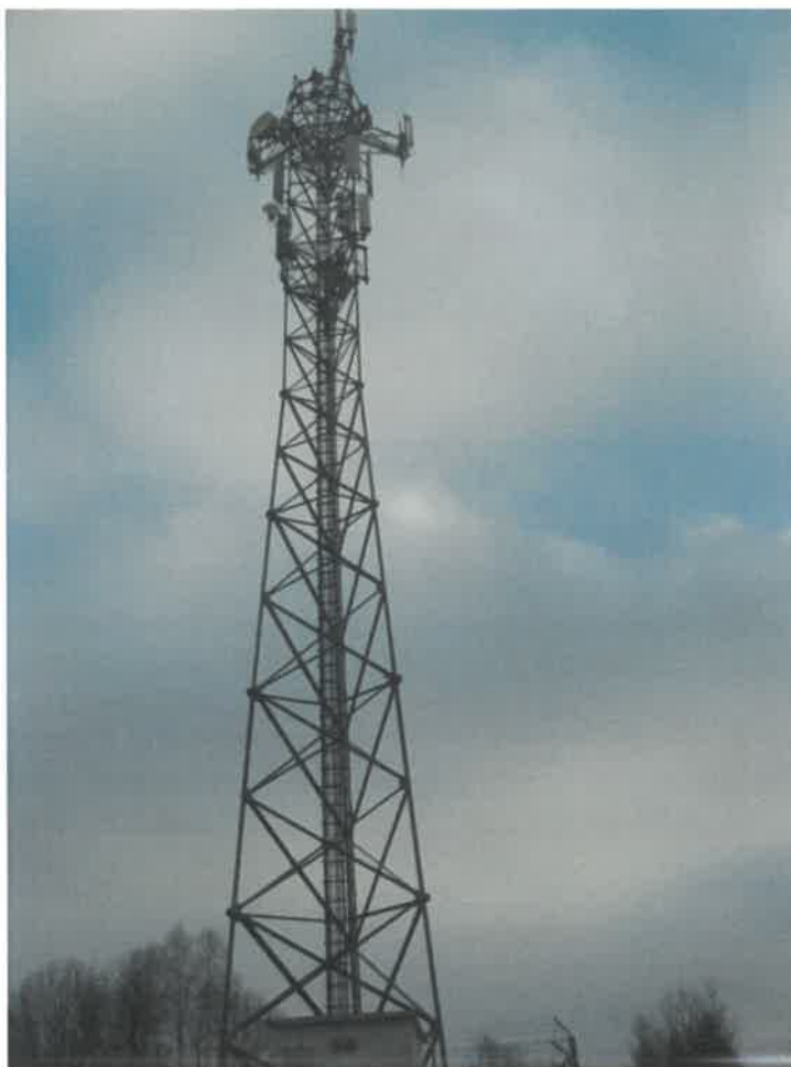
Zał. nr 1: Widok ogólny instalacji radiokomunikacyjnej.
